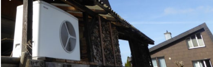
Luft-Wasserwärmepumpe im Unterbach
