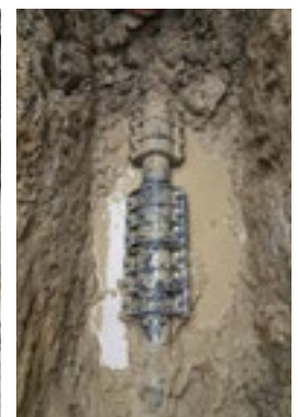
▲ Zwei Reparaturen innert kürzester Zeit an der gleichen Stelle (2 Stk. Rohrschellen)
