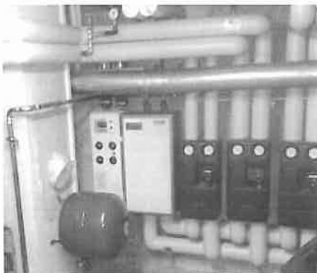
Fernwärmeanschluss (Befang Trogen)
